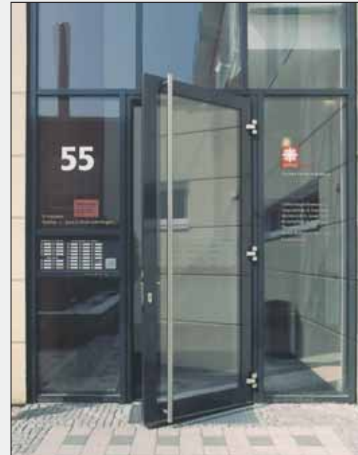
Wärme gedämmte Stahltür, „STW-1“
